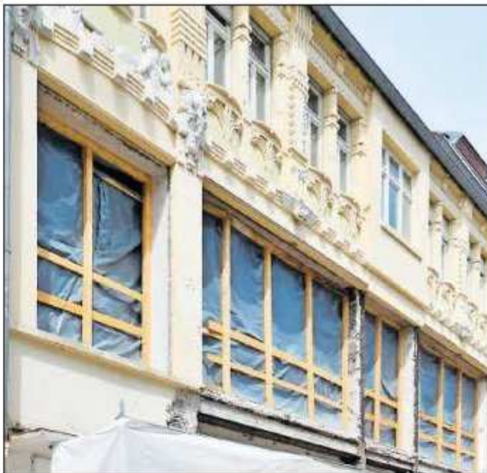
Nach dem ersten Verkauf 2013 wurde das Gebäude entkernt. Zurzeit hängt ein Banner vor der Fassade. ARCHIVFOTO: MEHN
